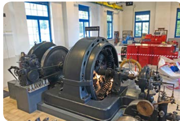
Im Vordergrund der erste Generator
